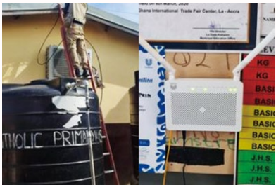
写真1: 小学校におけるwifiの整備
